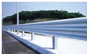
ガードレール
