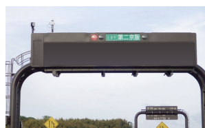
高速道路情報板フレーム（支柱）
